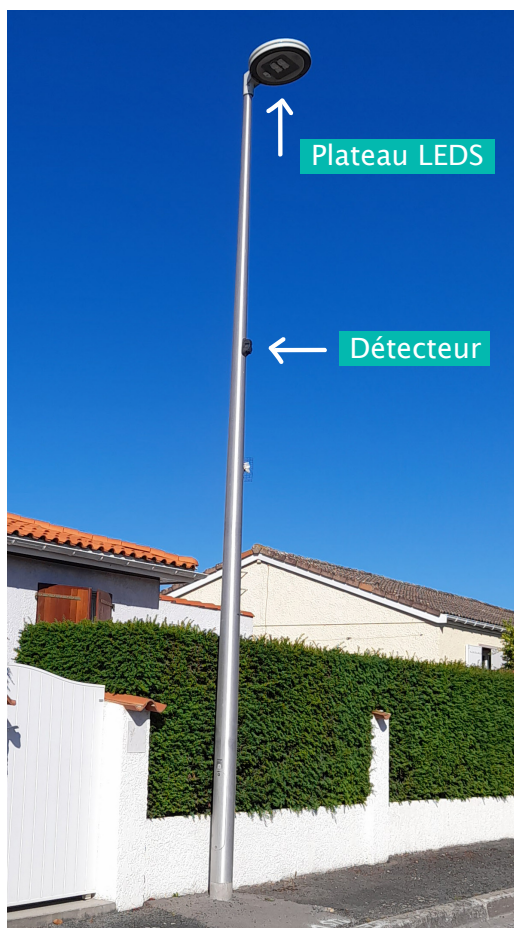
~~~~~ Exemple de candélabre équipé d'un système d'éclairage à LEDS avec détection ~~~~~
